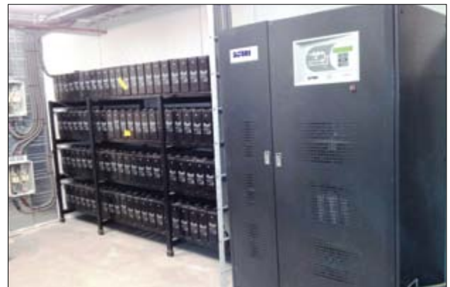
Skatteverkets huvudkontor Solna 1 x 300kVA + 2 x 60kVA
