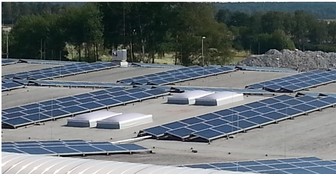
Åskskydd av solpaneler norr om Stockholm.
