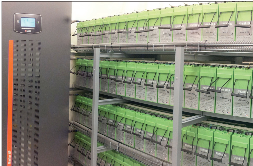
Större batterisystem med MHT 200kVA
