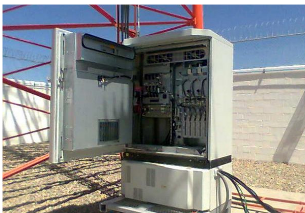
Överspänningsskydd för radiobasstation.
