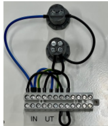
230V IN/UT samt Fjärrstyrning
