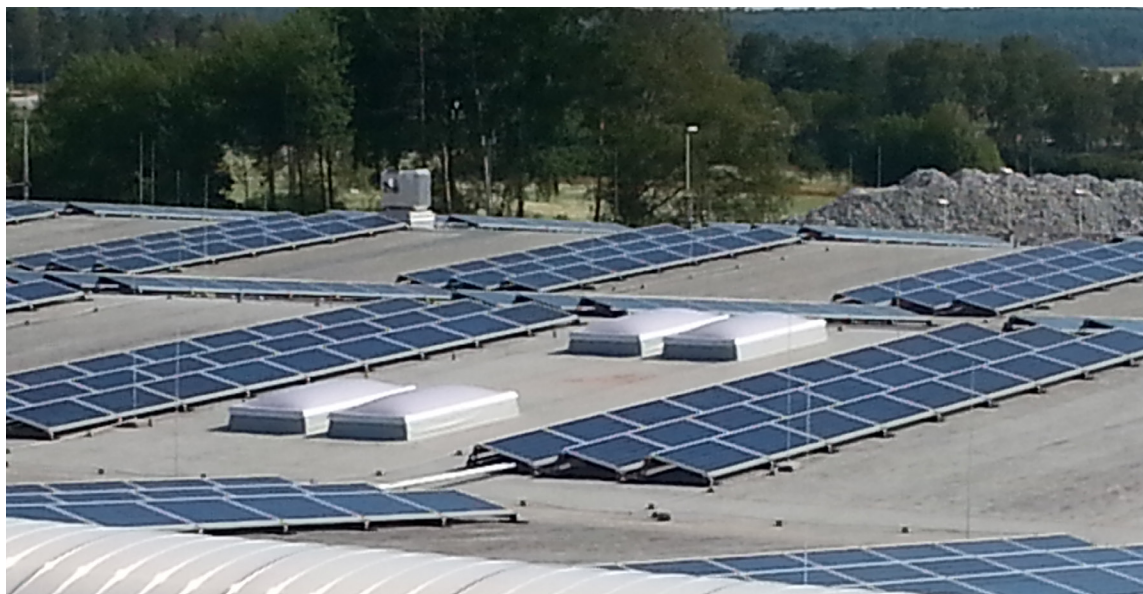
Åskskydd av solpaneler norr om Stockholm.
