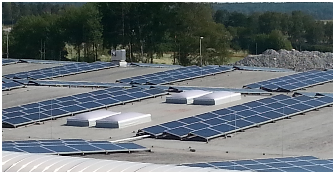
Åskskydd av solpaneler norr om Stockholm.
