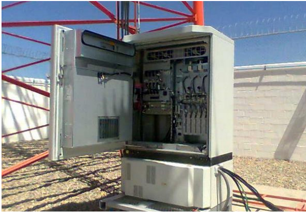
Överspänningsskydd för radiobasstation.
