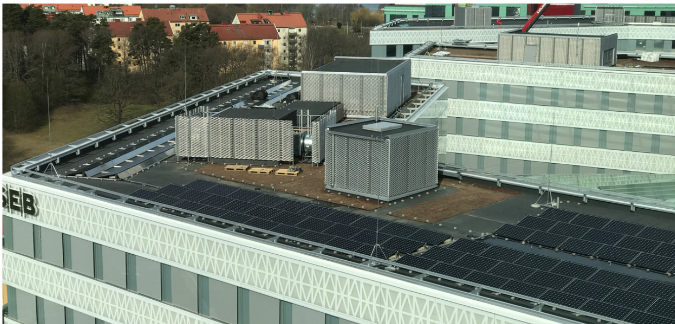
Åtskydd av solpaneler norr om Stockholm.
