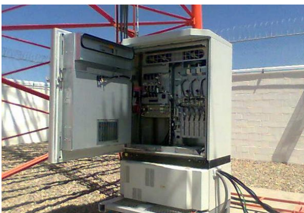
Överspänningsskydd för radiobasstation.
