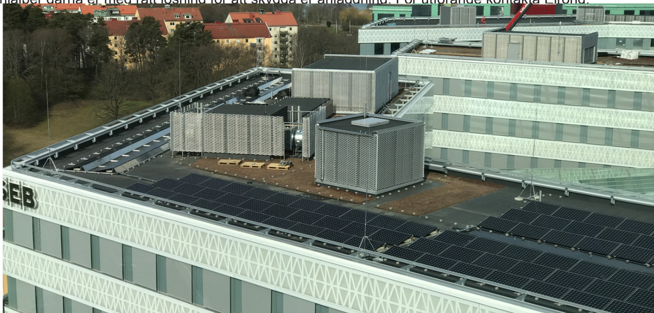
Åskskydd av solpaneler norr om Stockholm.
