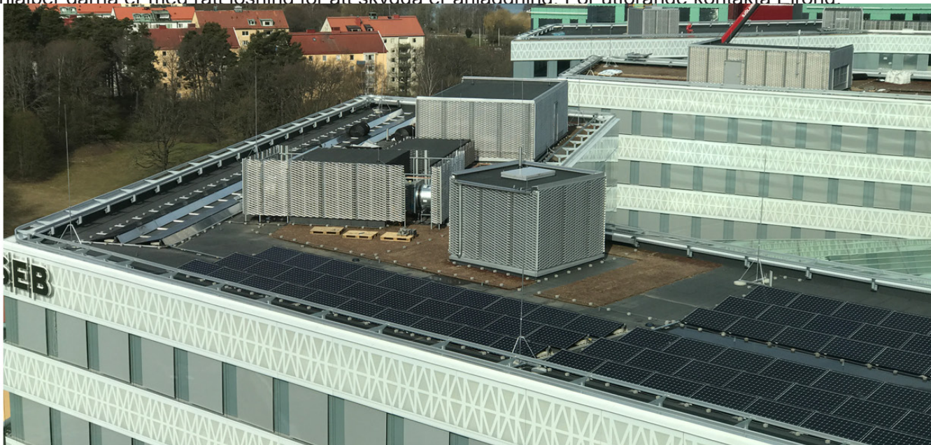
Åskskydd av solpaneler norr om Stockholm.
